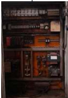
Gambar 7. Panel kontrol sebelum pembaruan
