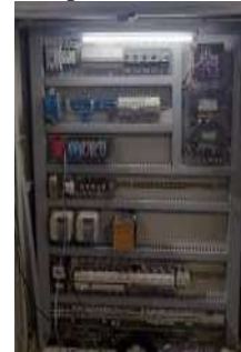
Gambar 8. Panel kontrol setelah pembaruan
