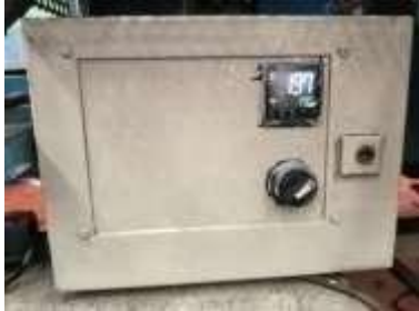
Gambar 12. Panel Sistem Kontrol Heater Sesudah Modifikasi
