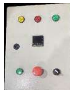
Gambar 6. Panel Kontrol Bagian Luar
